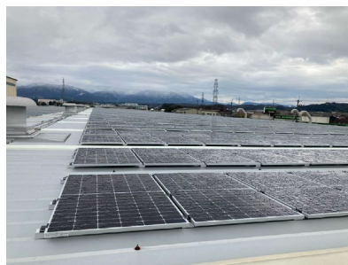
太陽光パネル
