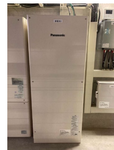
定置用蓄電池
