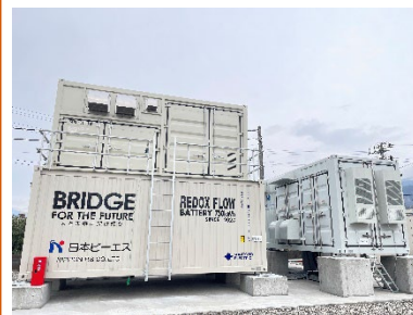
定置用蓄電池
