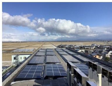
太陽光パネル
