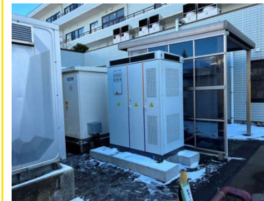
定置用蓄電池
