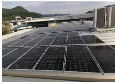
太陽光パネル
