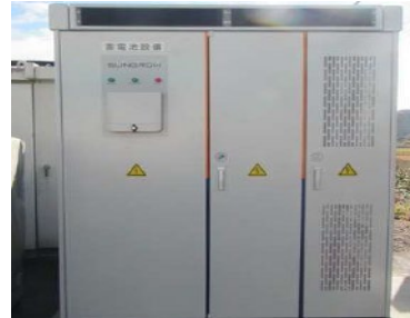
定置用蓄電池
