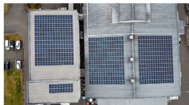
太陽光パネル
