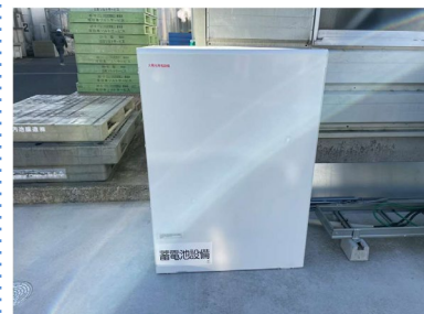
定置用蓄電池
