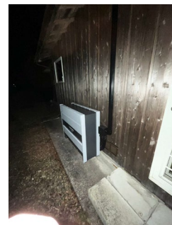
定置用蓄電池
