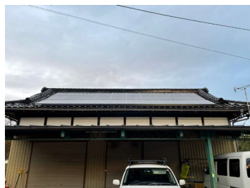
太陽光パネル
