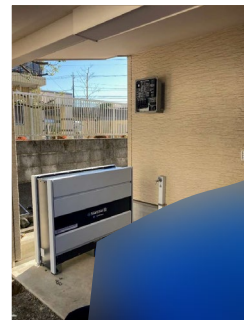
定置用蓄電池
