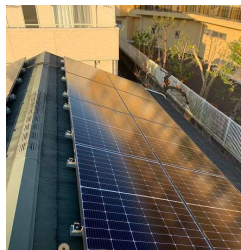
太陽光パネル
