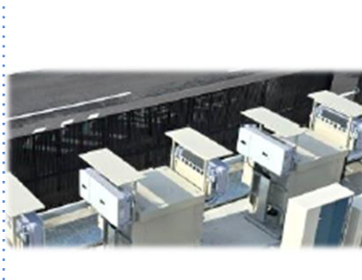
パワーコンディショナー、変圧器
