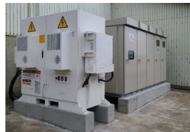
定置用蓄電池
