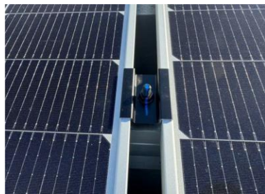
太陽光パネル
