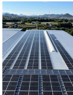
太陽光パネル
