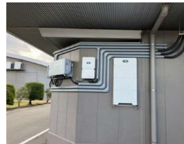
パワーコンディショナー/定置用蓄電池
