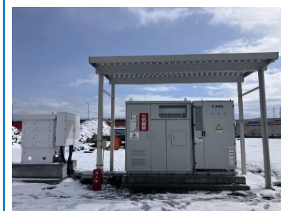
定置用蓄電池・トランス
