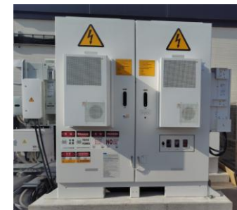
定置用蓄電池
