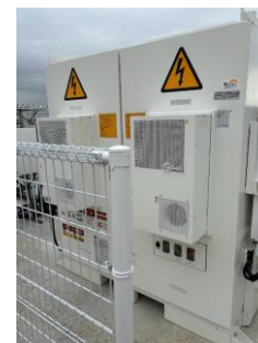
定置用蓄電池
