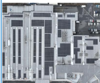
太陽光パネル
