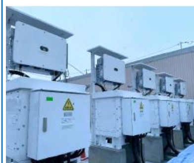
パワーコンディショナー/変圧器
