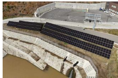
太陽光パネル
