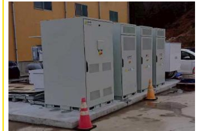
定置用蓄電池
