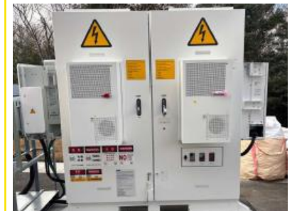
定置用蓄電池
