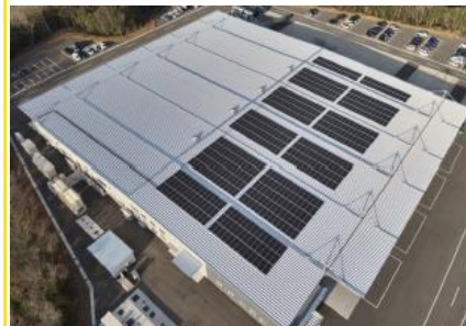
太陽光パネル
