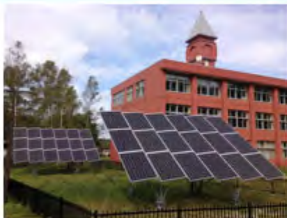
避難所に設置した太陽光発電
