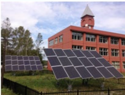
避難所に設置した太陽光発電
